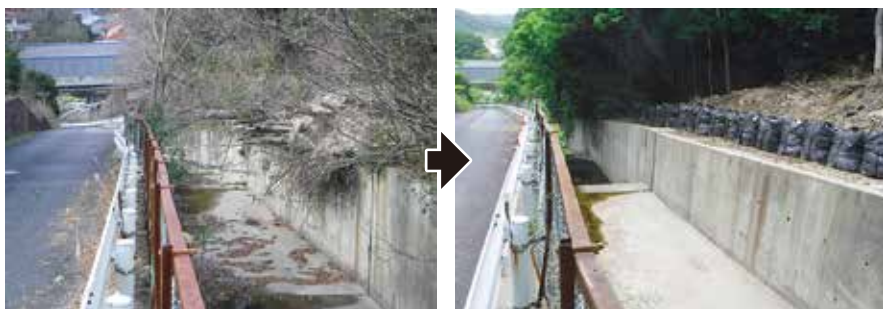
土砂崩れを処理(白川)
